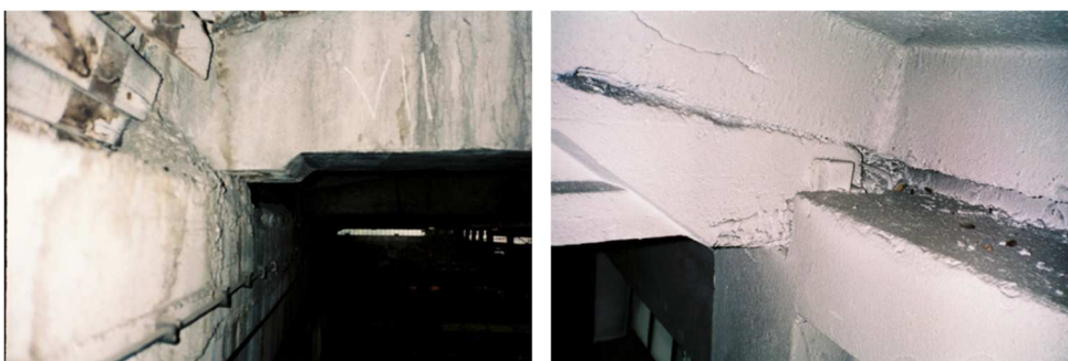
Rys. 13. Przykłady zbyt płytkiego oparcia dźwigarów
