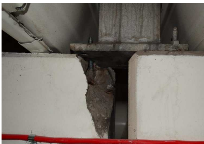
Rys. 35. Przykład niepoprawnego kotwienia podpory centrali klimatyzacyjnej do dźwigarów dachowych
