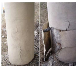
Rys. 28. Zniszczenie paroszczelnej powłoki na zawilgoconym elemencie betonowym
