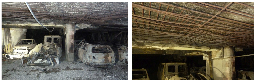
Rys. 15. Wygląd stropu zniszczonego w wyniku pożaru, głównie na skutek odpryskiwania termicznego betonu; fot. R. Kowalski
