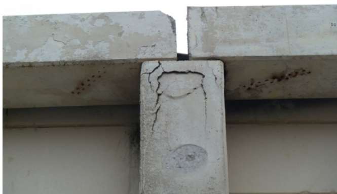
Rys. 4. Wygląd uszkodzenia głowicy słupa prefabrykowanego, spowodowanego odkształcalnością termiczną zamocowanych do niego belek; charakter uszkodzeń wskazuje, iż wystąpiły one podczas skracania się stygnących elementów; fot. R. Kowalski
