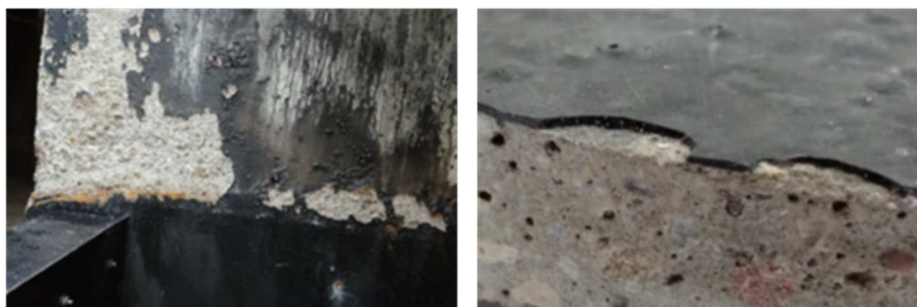
Rys. 31. Ponowne uszkodzenia zbiornika
