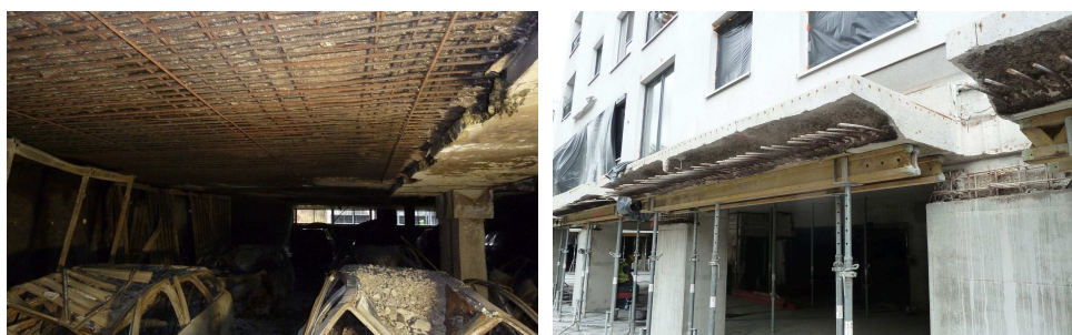
Rys. 16. Wygląd stropu zniszczonego w wyniku pożaru, głównie na skutek odpryskiwania termicznego betonu; fot. R. Kowalski
