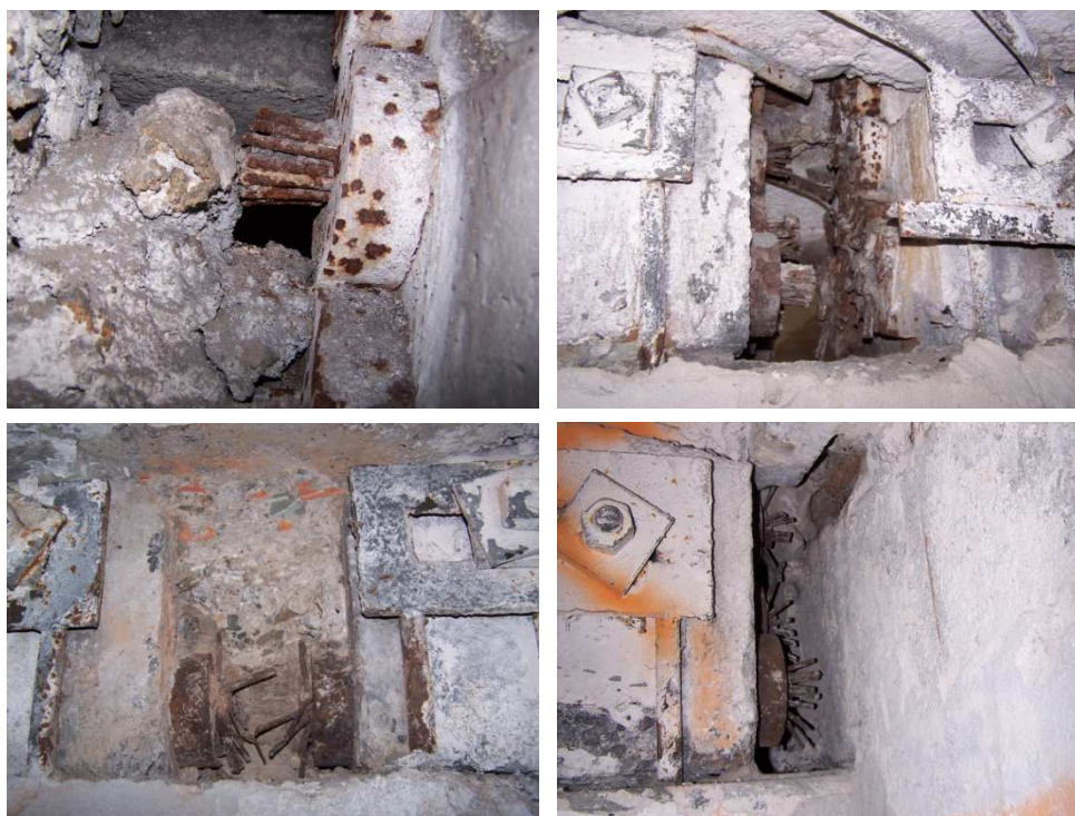
Rys. 16. Przykłady wadliwego obetonowania stref zakotwień
