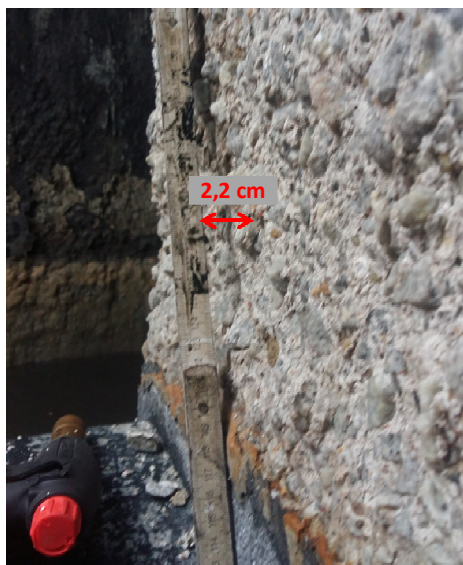
Rys. 33. Fragment ściany zbiornika z głębokimi ubytkami betonu otuliny zbrojenia
