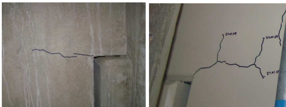
Rys. 25. Zarysowanie belek w strefie podcięć podporowych
