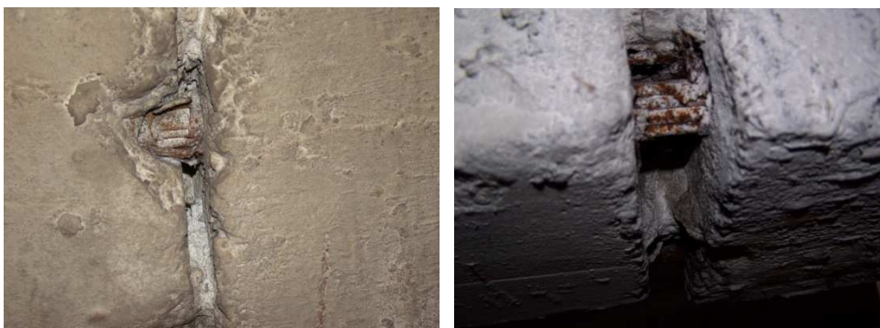
Rys. 11. Przykłady korozji kabli sprężających w wadliwych stykach
