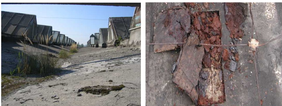
Rys. 21. Przykłady stanu technicznego pokryć dachowych i izolacji
