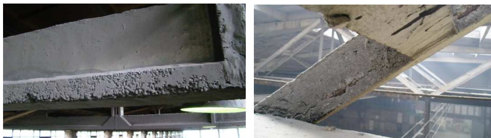
Rys. 9. Przykłady wad struktury betonu
