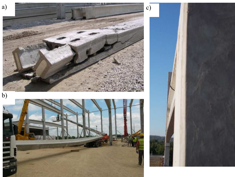
Rys. 32. Elementy uszkodzone w trakcie montażu: a) nieprawidłowo podnoszona płyta kanałowa, b) dźwigar po wywrocie w trakcie manewrowania na placu budowy, c) zamontowany skrzywiony dźwigar
