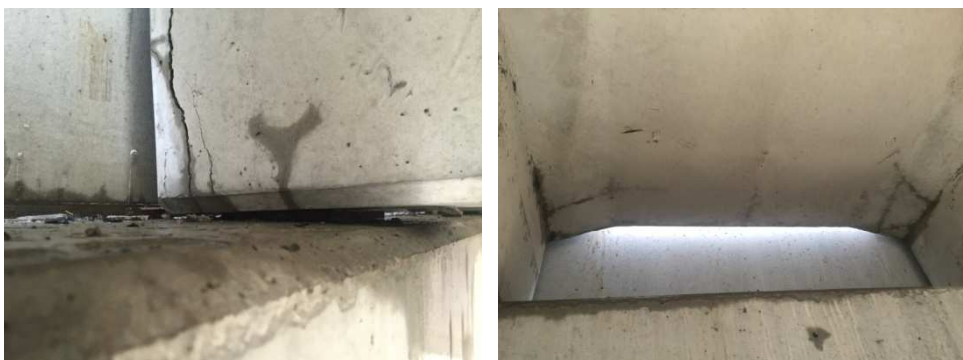
Rys. 29. Przykłady uszkodzeń stref podporowych płyt TT opartych na skrzyżowanych podciągach
