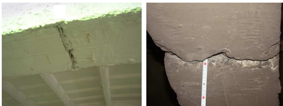
Rys. 10. Przykłady wadliwie wykonanych styków segmentów w pasach dolnych
