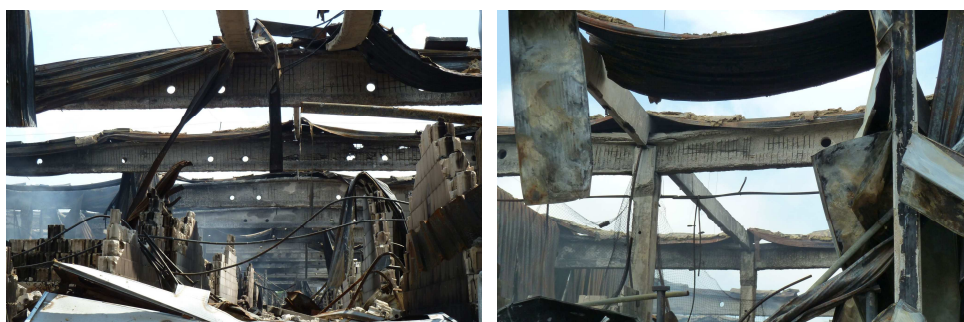
Rys. 12. Wygląd dźwigarów strunobetonowych zniszczonych w wyniku pożaru; fot. R. Kowalski
