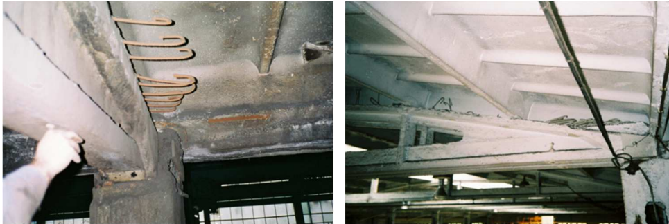
Rys. 5. Przykłady niewłaściwego oparcia płyt dachowych (w konsekwencji braku nadbetonu) spowodowanego zastosowaniem normy [N24]
