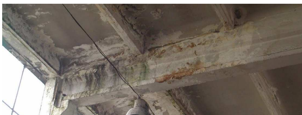
Rys. 34. Przykład długotrwanie zawilgoconego dźwigara strunobetonowego
