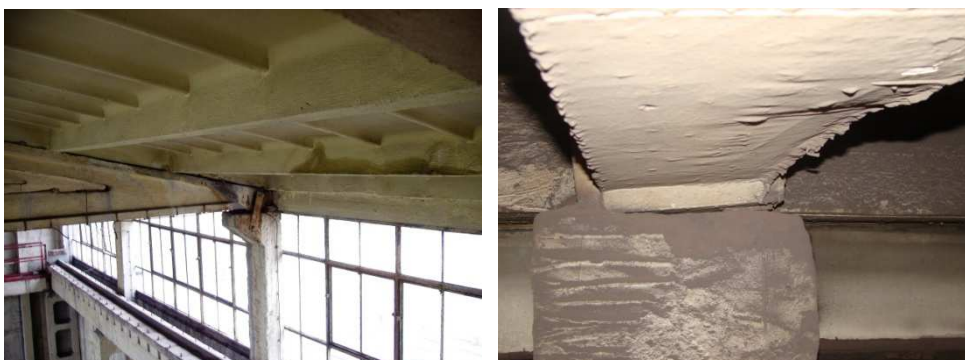
Rys. 14. Przykłady zbyt głębokiego lub niesymetrycznego oparcia dźwigarów
