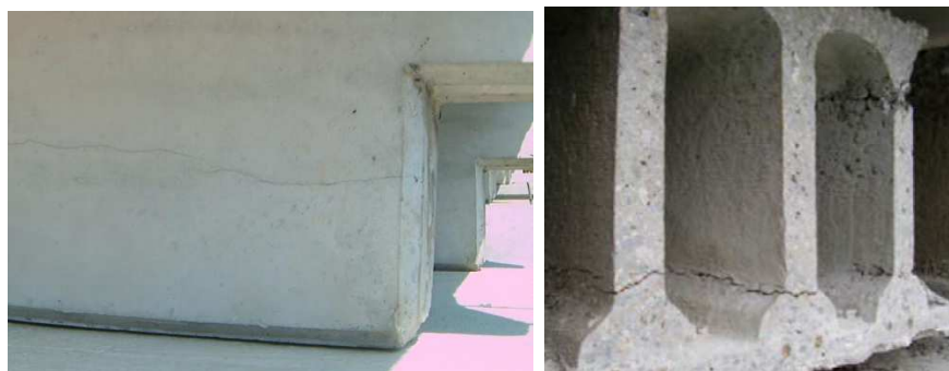
Rys. 26. Zarysowanie spowodowane rozszczepieniem w strefie kotwienia cięgien: a) płyta TT, b) płyta kanałowa [7]
