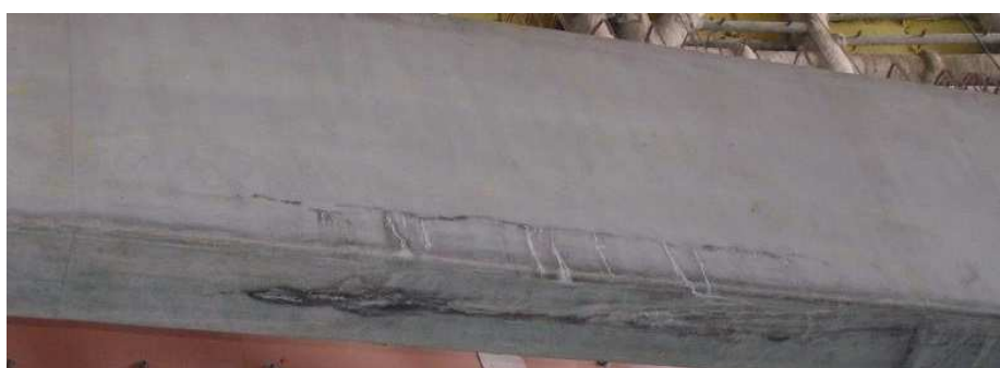
Rys. 31. Uszkodzenie belki typu V spowodowane zamarznięciem zgromadzonej w niej wody
