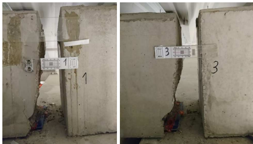
Rys. 24. Uszkodzenie strefy podparcia kolejnych płatwi w linii dylatacji
