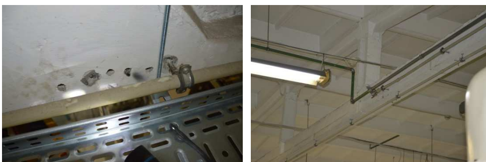
Rys. 22. Przykłady uszkodzeń spowodowanych wadliwym montażem wyposażenia
