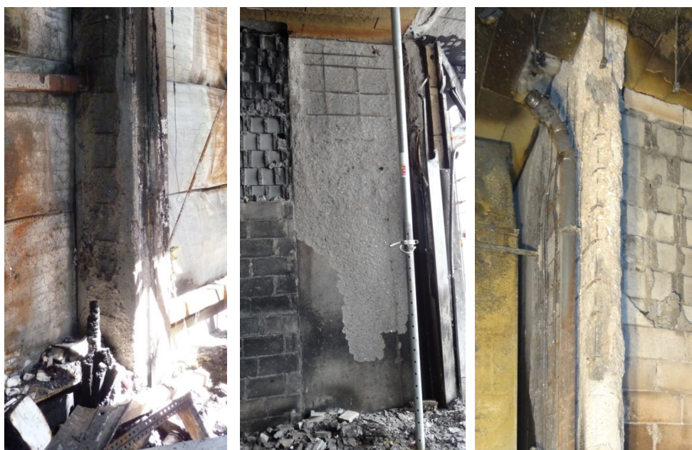
Rys. 11. Odpryskiwanie termiczne betonu w słupach żelbetonowych; fot. R. Kowalski
