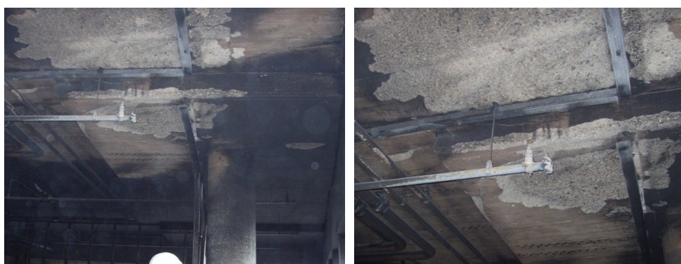
Rys. 14. Wygląd stropu, w którym wystąpiło systematyczne odpryskiwanie termiczne betonu; fot. R. Kowalski
