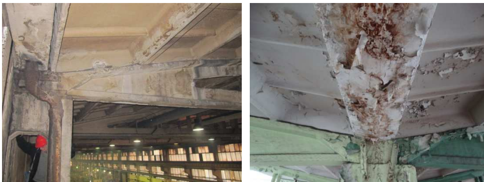
Rys. 6. Przykłady przecieków w płytach ściekowych na stykach naw
