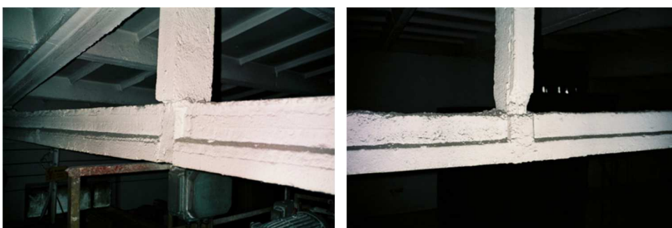
Rys. 12. Przykłady wadliwego osadzenia prefabrykowanych słupów
